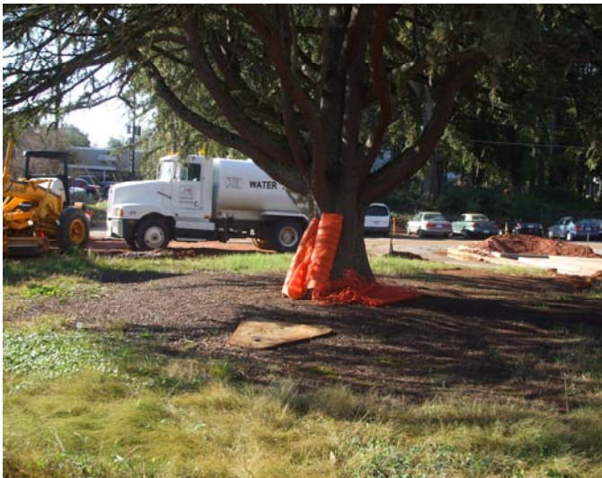
Daño esta posible si la barrera no está armado bien antes de la construcción
